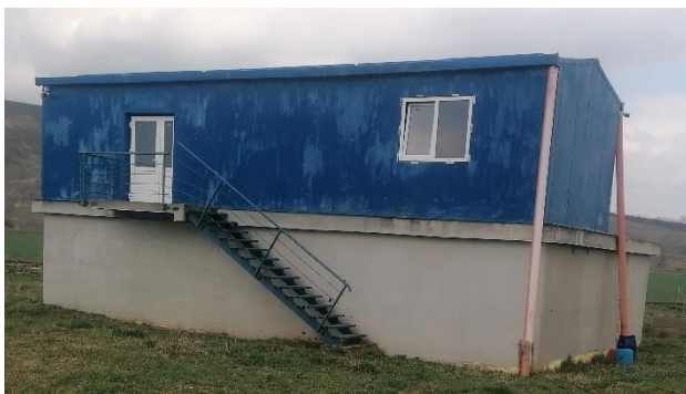
Stație de epurare - Vidrasău
